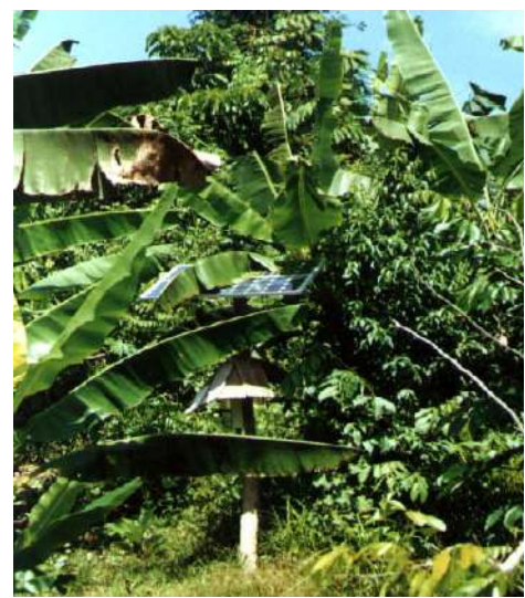
Figura 3.19 – Sombreamento de módulos fotovoltaicos por vegetação arbórea, AM. (Foto: M.C. Fedrizzi, 2002)
