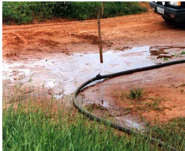
Figura 3.42 – Vazamento nos ramais secundários. (Foto: M.C. Fedrizzi, 1999)
