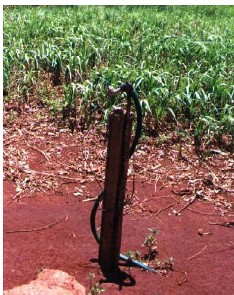
Figura 3.29 – Torneira em mal estado de fixação, em aldeia Kaiowá, MS. (Foto: M.C. Fedrizzi, 2000)
