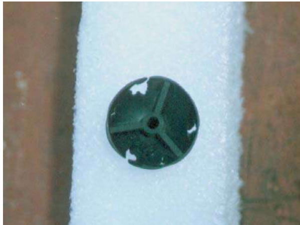
Figura 3.9 – Diafragma de bomba danificado pela grande quantidade de areia em suspensão existente na água bombeada, AM. (Foto: M.C. Fedrizzi, 2003)
