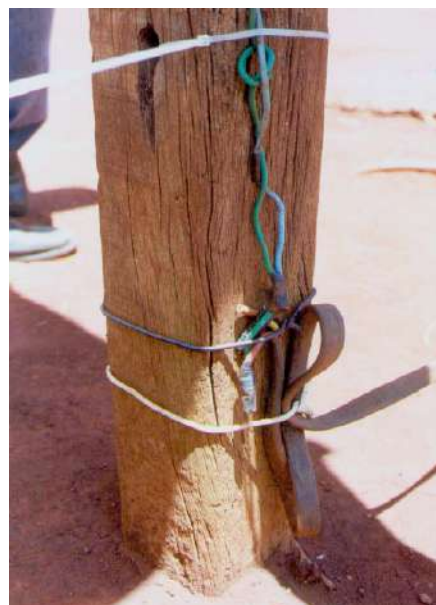
Figura 3.24 – Detalhe da estrutura de sistema de bombeamento fotovoltaico, com fiação e conexões inadequadas. (Foto: M.C. Fedrizzi, 2000)
