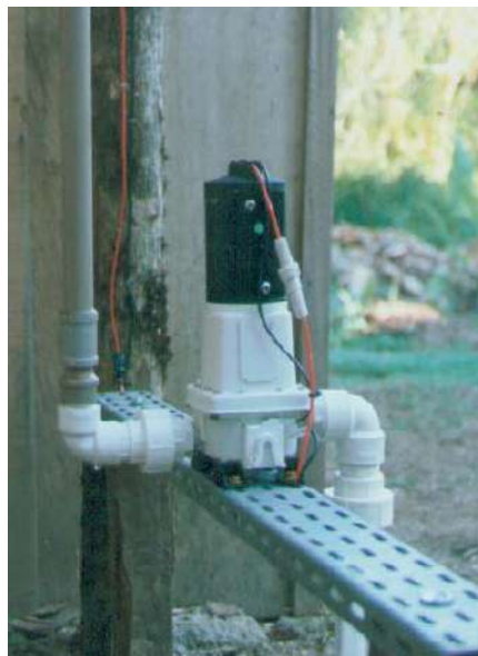
Figura 4.1 – Sistema de bombeamento fotovoltaico de superfície. (Foto: M.C. Fedrizzi, 1998)
