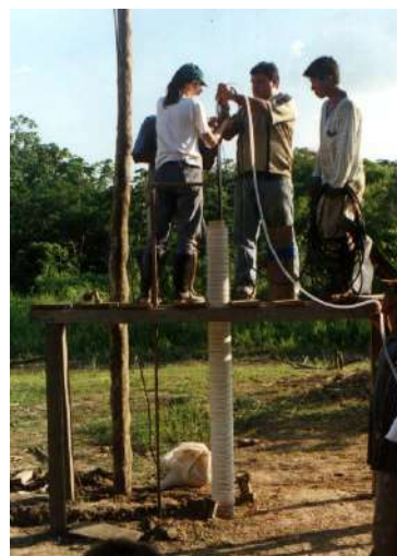
Figura II.10 Instalação de um grupo motobomba. (foto: M.C. Fedrizzi, 1999)
