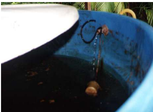
Figura 3.10 – Interior de reservatório, precário cuidado com a limpeza, PTU, AM. (Foto: M.C. Fedrizzi, 2001)
