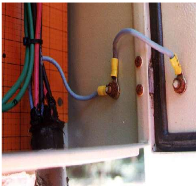
Figura 3.23 – Detalhe da caixa de controle de um sistema de bombeamento apresentando conexões oxidadas. (Foto: M.C. Fedrizzi, 2000)
