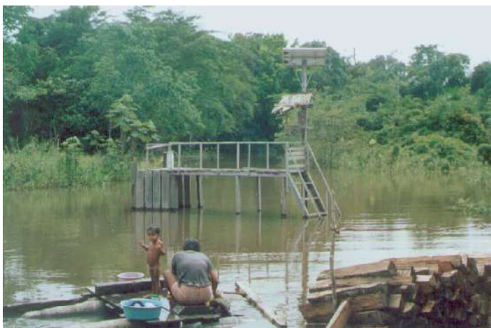
Figura 4.6 – Sistema de bombeamento na várzea, em terreno com baixa permeabilidade, em época das chuvas. (Foto: M.C. Fedrizzi, 2002)
