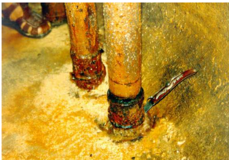
Figura 3.26 – Tubulação de ferro galvanizado perfurada por corrosão. (Foto: E. Lorenzo, 1998)
