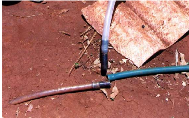
Figura 3.25 – Conexão de polietileno apresentando rompimento. (Foto: M.C. Fedrizzi, 2000)
