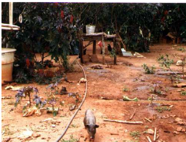
Figura 3.27 – Tubulação exposta à intempérie, SP. (Foto: M.C. Fedrizzi, 1999)
